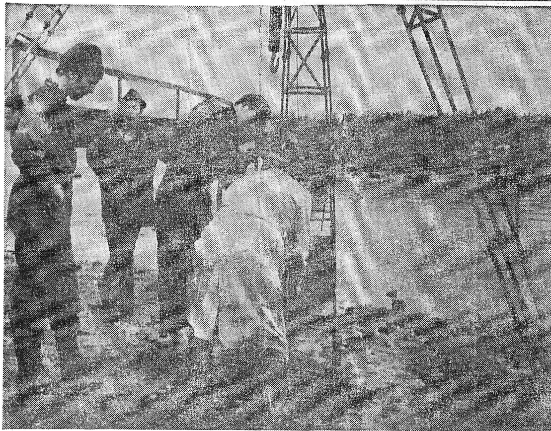
Fra grunnundersøkelsene i Valløybukten, hvor det bores og tas prøver av grunnen i forbindelse med det nye småbåthavn-prosjekt som blir fremmet av Surka Båthavn (stiftet våren 1970). I bakgrunnen, ved bryggen, sivilingeniør Bjørn Strøm som av foreningen er engasjert som konsulent og som sådan forestår den grunnundersøkelse som avsluttes i disse dager.
